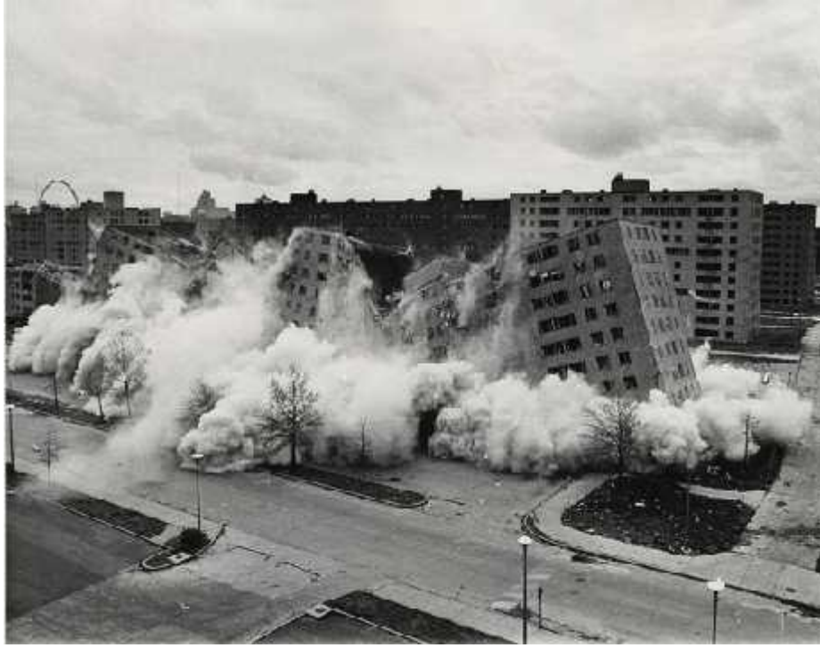
الشكل (٢-١٤) تهديم المجمع السكني (Pruitt-Igoe) صممها المعمار ياماساكي في سانت لويس/ أميركا.
